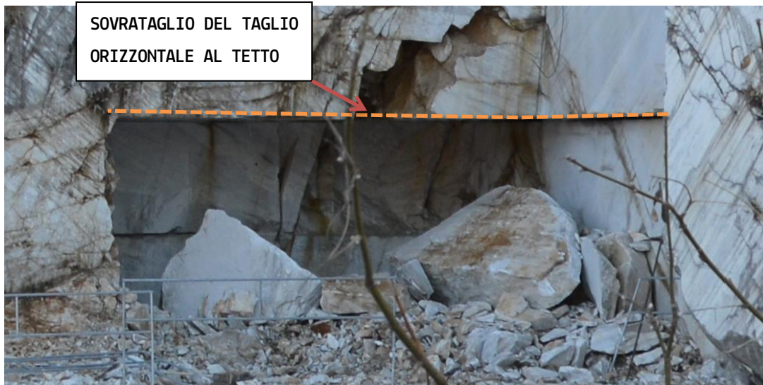
Figura 16: Particolare del tratto di galleria imputato con indicato il taglio al tetto in prosecuzione di quello più esterno coincidente con il tratto di sotterraneo rimosso per franamento del portale.
