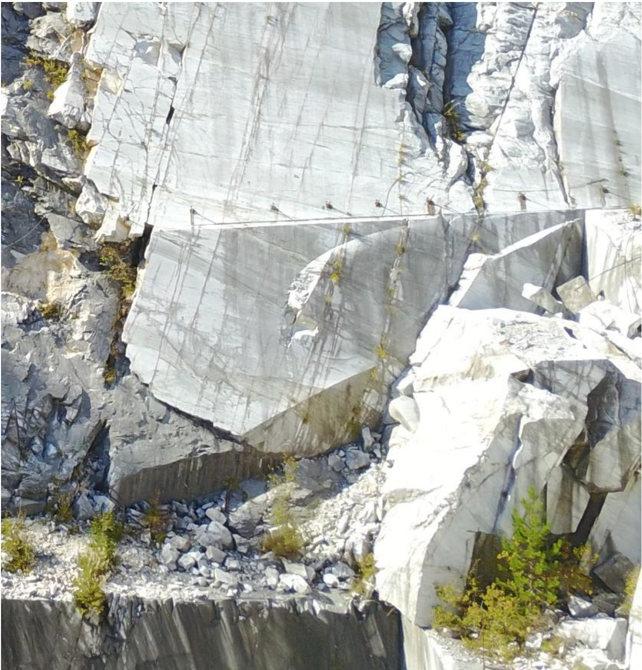
Figura 14: Foto del 2017 dell'area di ubicazione del tratto di galleria dove si riconosce il portale di accesso crollato.
