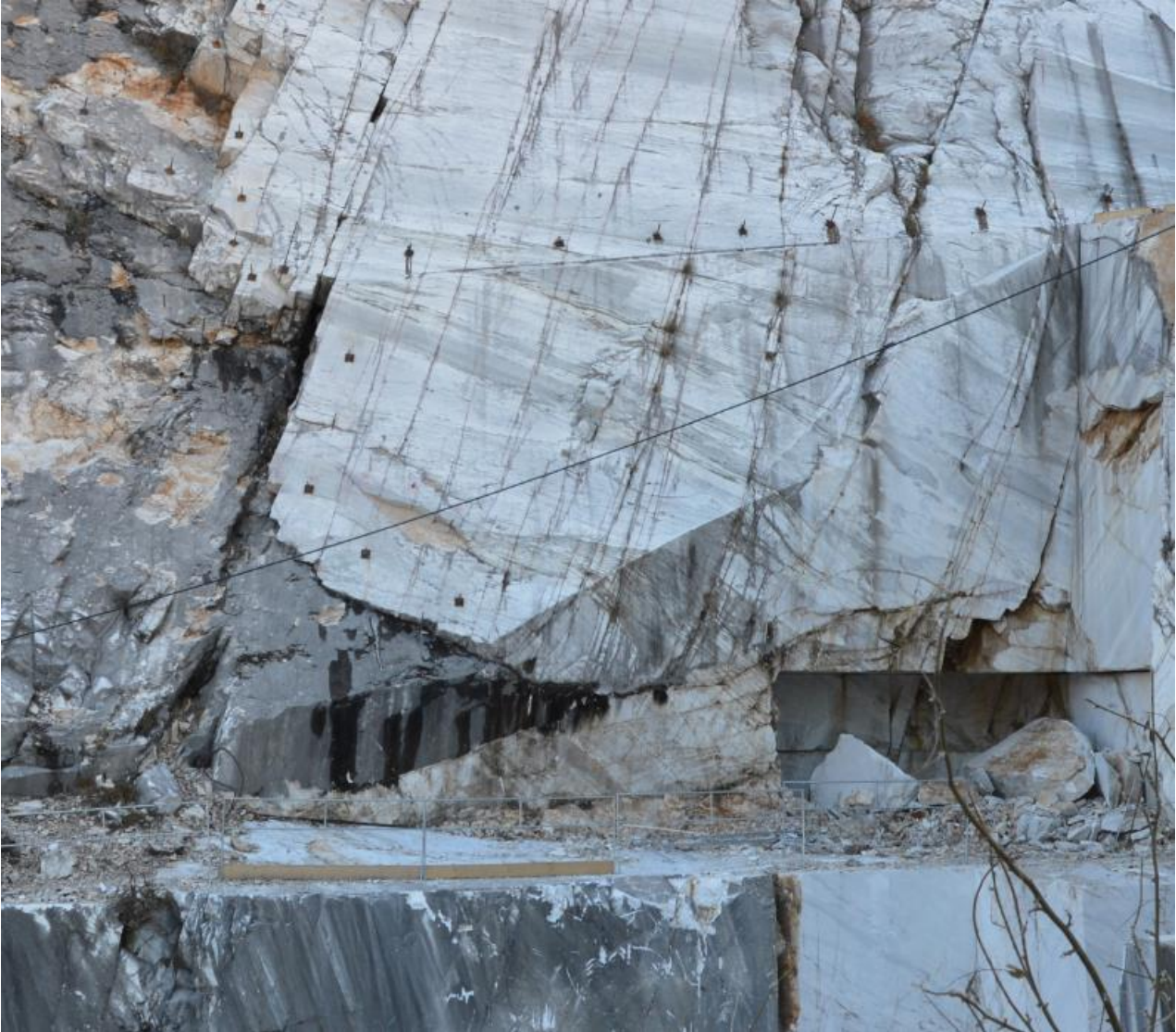
Figura 15: Foto del 2018 dell'area di ubicazione del tratto di galleria dove si riconosce il portale di accesso crollato.
