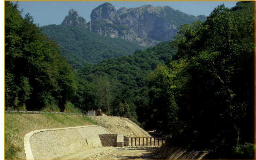
52 - Le Mulina: briglia selettiva nell'alveo del torrente selective filtering weir along the streambed
